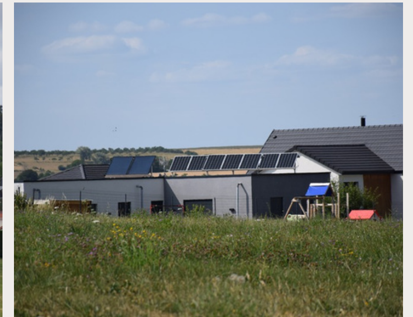
Problème de capteurs en saillie par rapport au toit (Vosges)
