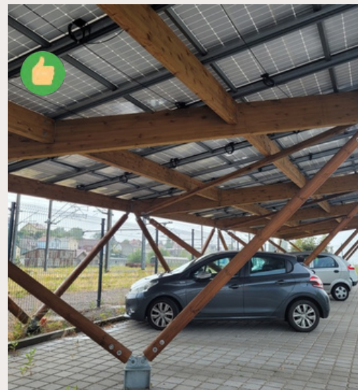
Exemple d'ombrière photovoltaïque réalisée avec des supports en bois local (Vosges)
