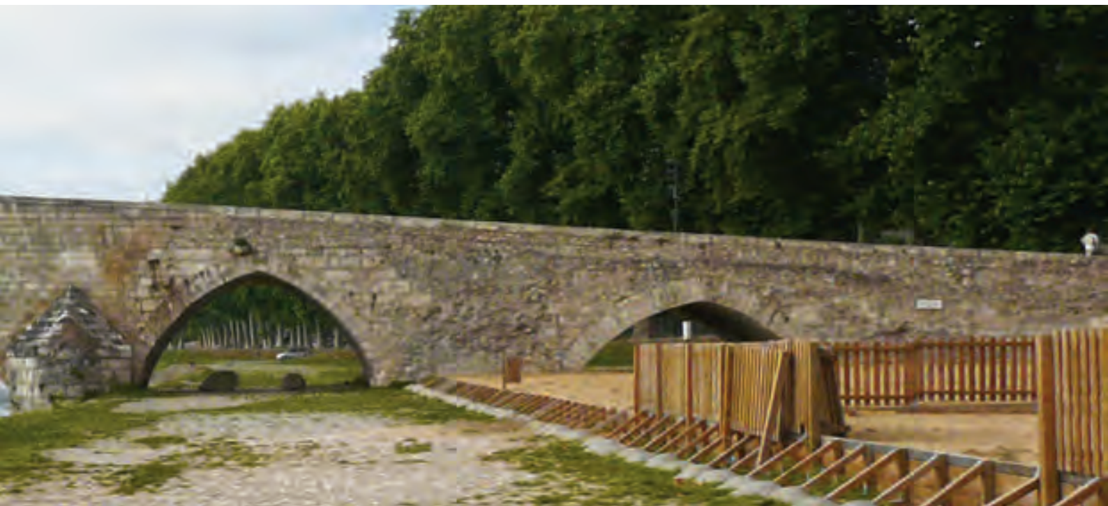
Ci-dessus : Beaugency. Intégrer les enjeux paysagers dans la gestion du Domaine Public Fluvial (gestion de la forêt alluviale et préservation des ouvrages remarquables)
